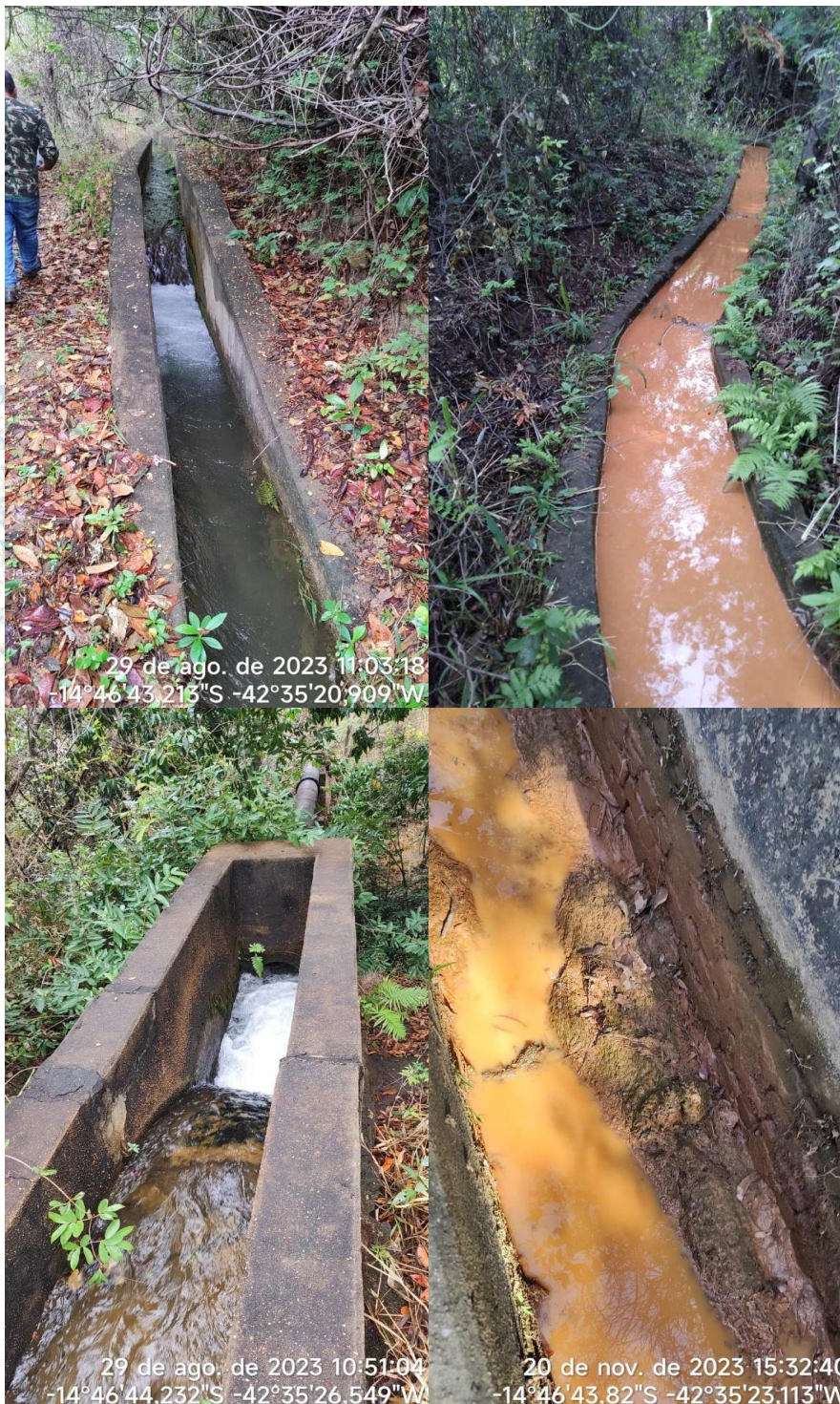
Figura 08: Situação da canaleta de captação da água para o abastecimento (antes e depois do ocorrido)
